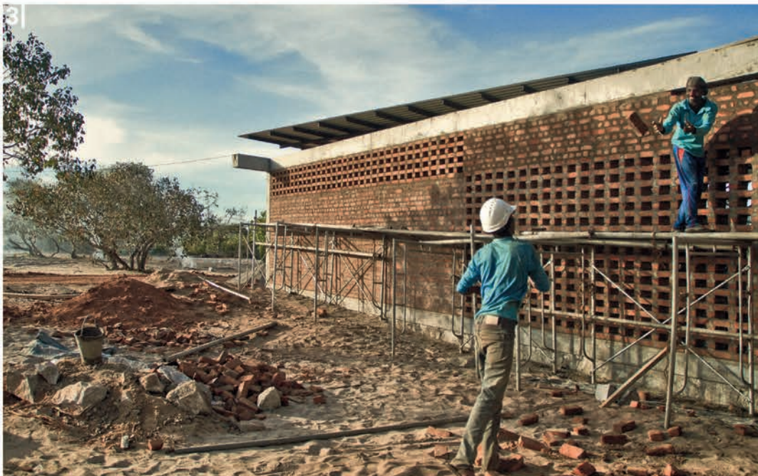
3) Bei Sichtmauerwerk ist präzision gefragt – mit der Bevölkerung vor Ort wird Hand in Hand gearbeitet
